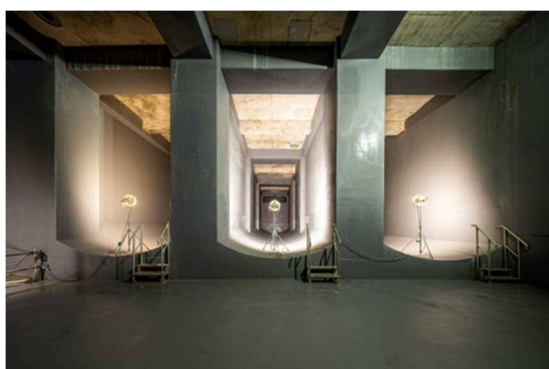
図表 5-8 渋谷駅東口地下に整備された雨水貯留施設
