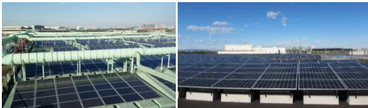
施設上部の設置例(森ヶ崎水再生センター反応槽上部) 下水処理施設の再構築用地などの設置例(南多摩水再生センター)
