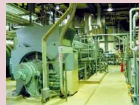
▲ガスエンジン発電機
