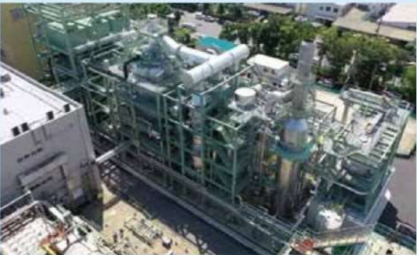
▲多層燃焼炉（新3号炉）
