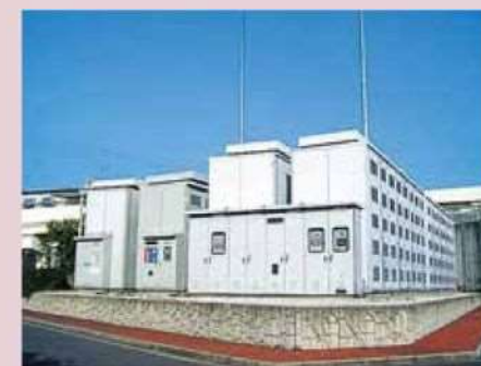
▲NaS電池設備
