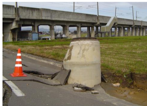
液状化によるマンホールの浮上 (③中越地震)
