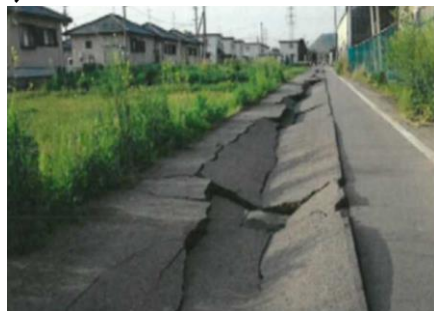
下水道管被災による道路陥没 (⑤熊本地震)
