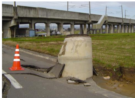
中越地震発生時の マンホールの浮上状況
