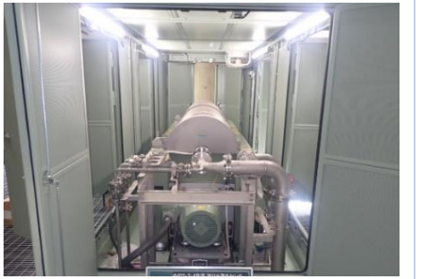
▲汚泥脱水機（浅川水再生センター）
