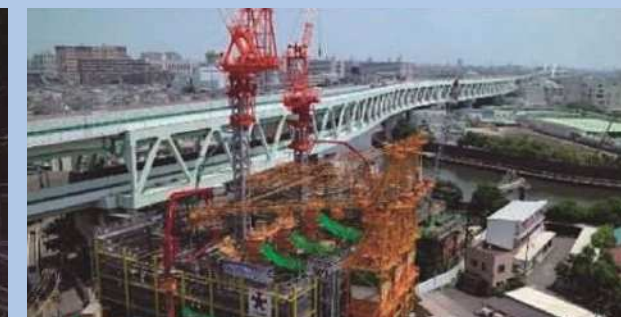
王子第二ポンプ所
