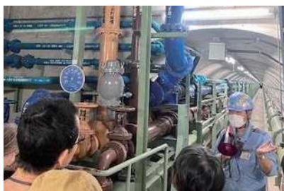
多摩川上流水再生センターを見学
