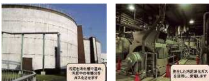
汚泥消化ガス発電（消化槽・発電機）
