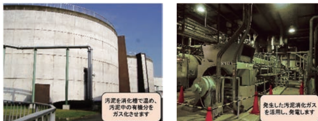
汚泥消化ガス発電（消化槽・発電機）
