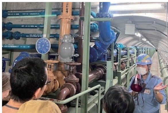
多摩川上流水再生センターを見学
