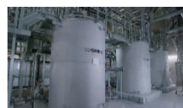
りん回収・肥料化施設
