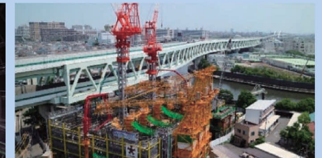
王子第二ポンプ所
