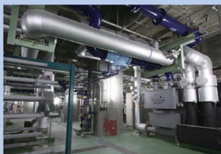
上部ビル全体の冷暖房を賄う 下水熱を利用した空調設備
