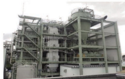
多摩川上流水再生センター ストーカ炉
