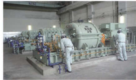
送風機の点検(北多摩一号水再生センター)
