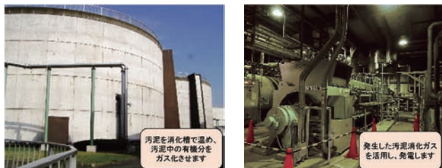
汚泥消化ガス発電（消化槽・発電機）
