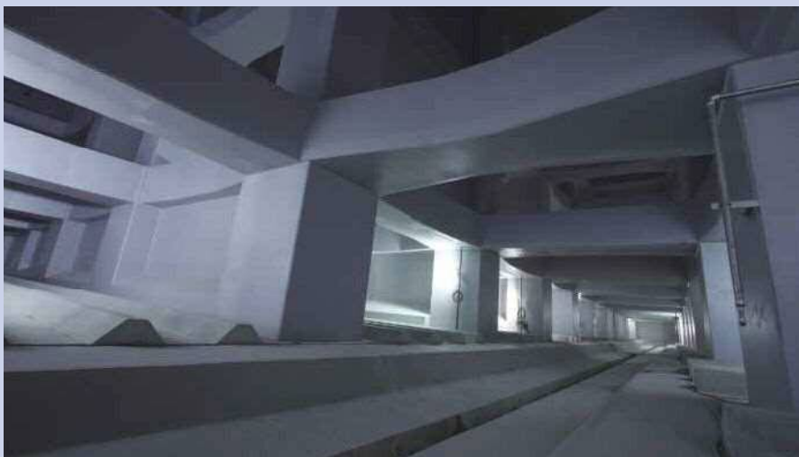
上部ビルの地下に設けられた雨天時貯留池
