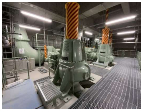
銭瓶町ポンプ所 汚水を水再生センターに送水
