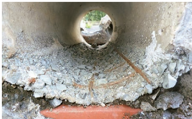
写真-1 取付管損傷（底部）
