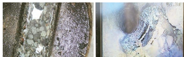
写真-2 汚水ますのイン パート部損傷 写真-3 取付管の損傷
