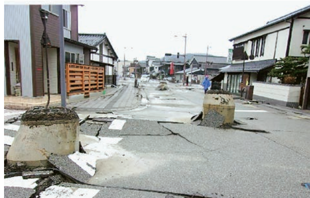
写真-1 液状化により浮上したマンホール
