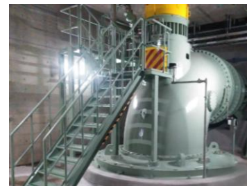
再構築を行ったポンプ設備(小菅水再生センター)
