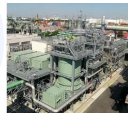
完成したエネルギー自立型焼却炉 (南部スラッジプラント)
