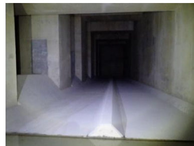
完成した千住関屋ポンプ所内の貯留施設
