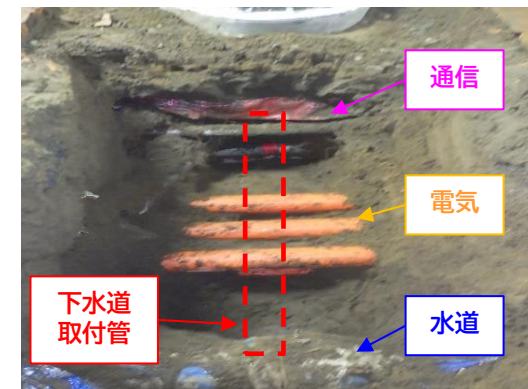
▲ 埋設物が密集している東京の地下空間
