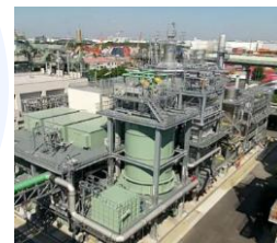
完成したエネルギー自立型焼却炉 (南部スラッジプラント)
