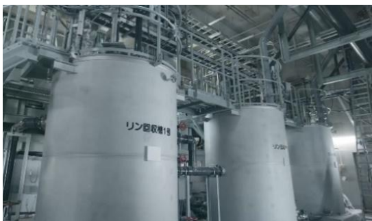
▲りん回収・肥料化施設
