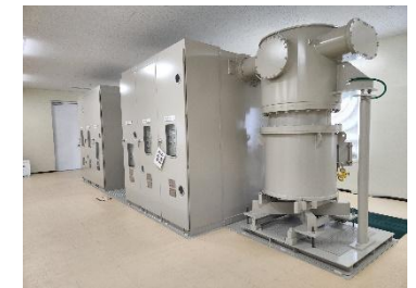
▲再構築を行った受変電設備 (北多摩二号水再生センター)
