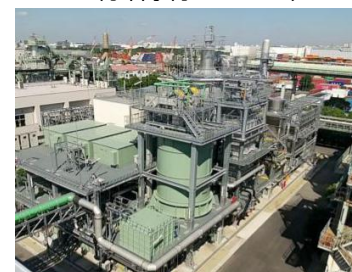
▲再構築を行った焼却設備 (南部スラッジプラント)
