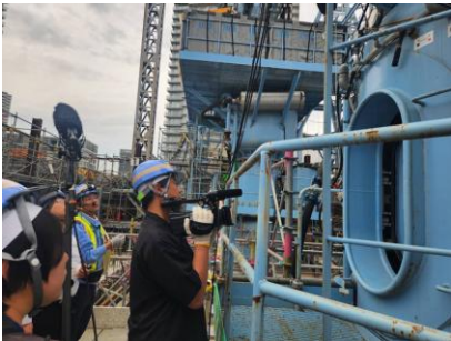
▲メディア向け施設見学会(江東ポンプ所)
