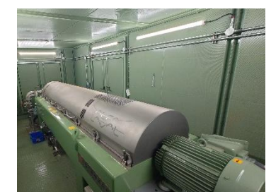
▲再構築を行った脱水設備 (北多摩一号水再生センター)
