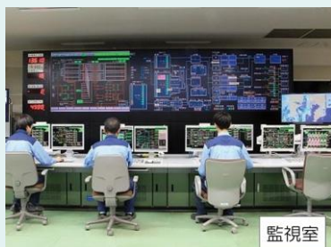
▲中央監視室での運転監視
