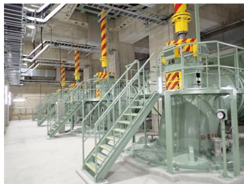
▲2026年3月に完成した千住関屋ポンプ所 (足立区千住地区)
