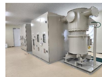
▲再構築を行った受変電設備 (北多摩二号水再生センター)
