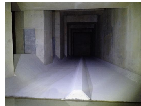
▲千住関屋ポンプ所内の貯留施設 (17,000m³)
