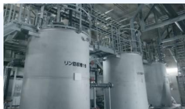
りん回収・肥料化施設
