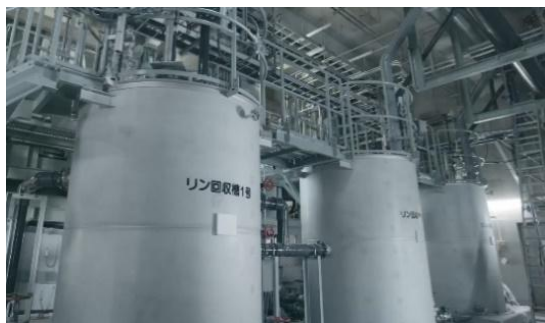
▲りん回収・肥料化施設
