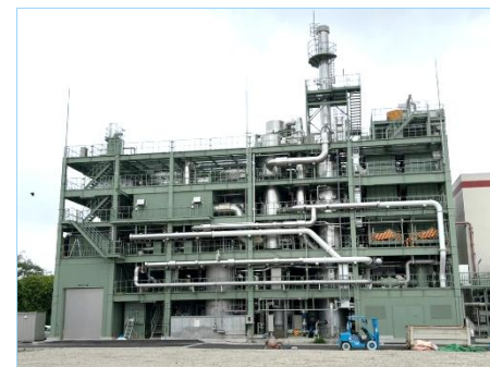
導入した省エネルギー型汚泥焼却炉 (北多摩一号水再生センター)
