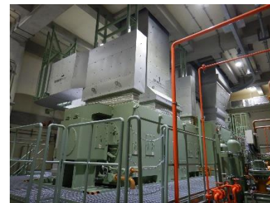
再構築後の発電設備(梅田ポンプ所)
