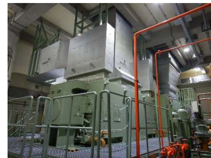
再構築後の発電設備(梅田ポンプ所)
