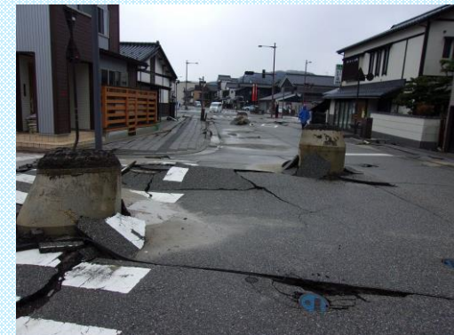
液状化現象によるマンホールの浮上
