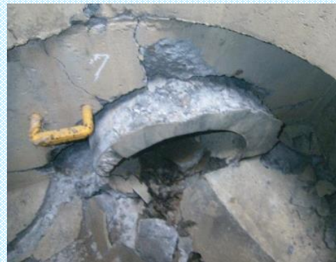
下水道管がマンホール内側に突き出した様子
