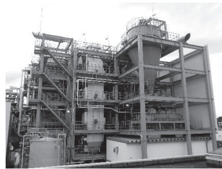
図表3-15 高効率な省エネルギー型焼却炉の例（多摩川上流水再生センター）
