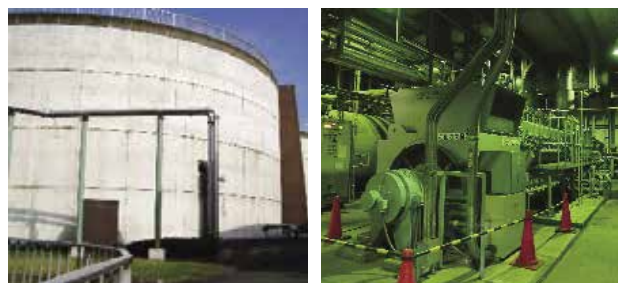
汚泥消化ガス発電（消化槽・発電機） （森ヶ崎水再生センター）
