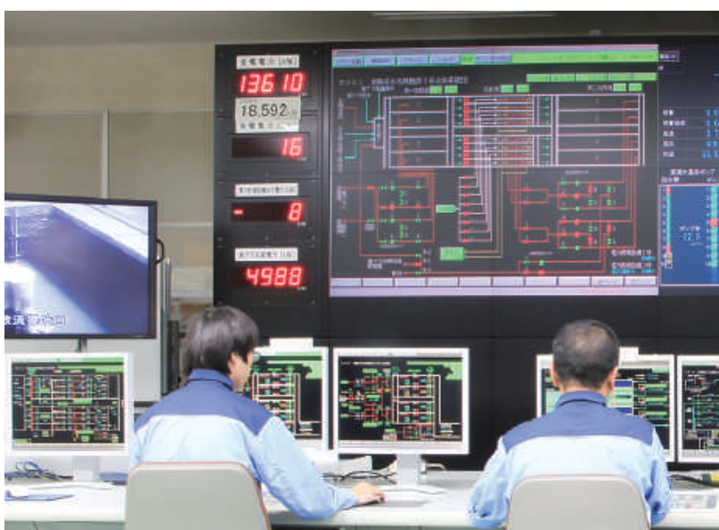
砂町水再生センター中央監視室
