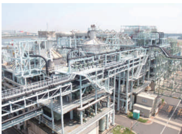
流動焼却炉（砂町水再生センター）
