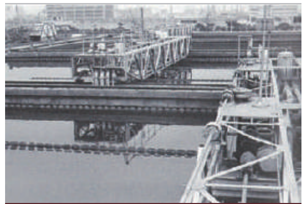
サイフォン式採泥機（三河島処分場）
