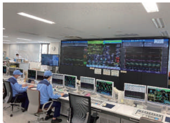
中央監視室監視盤（大型ディスプレイ）
