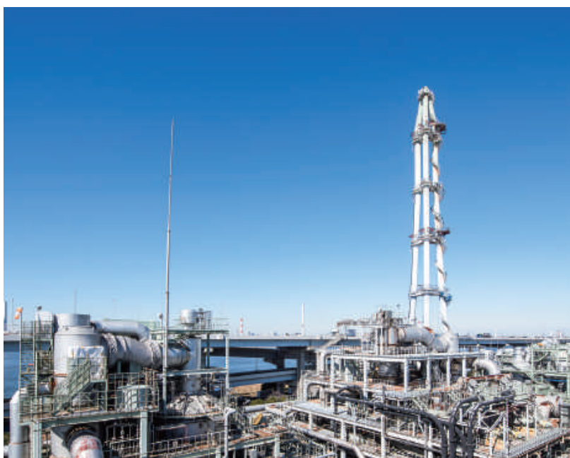
葛西水再生センター焼却炉（平成29年）
