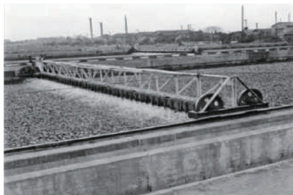
三河島污水処分場の散水ろ床
