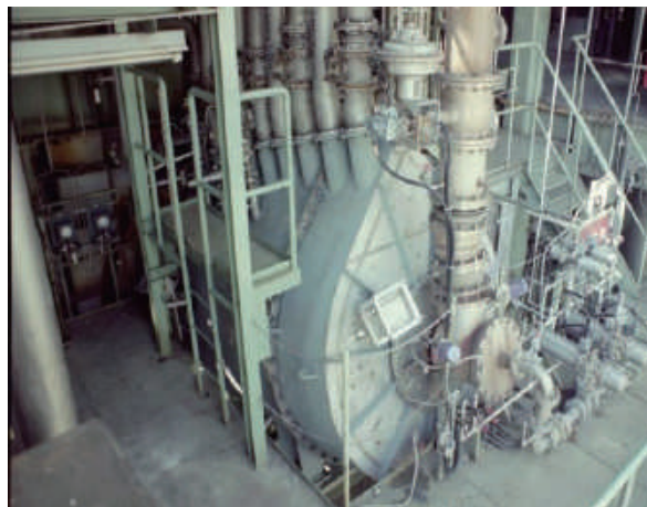
旋回溶融炉主要部（南部スラッジプラント）
