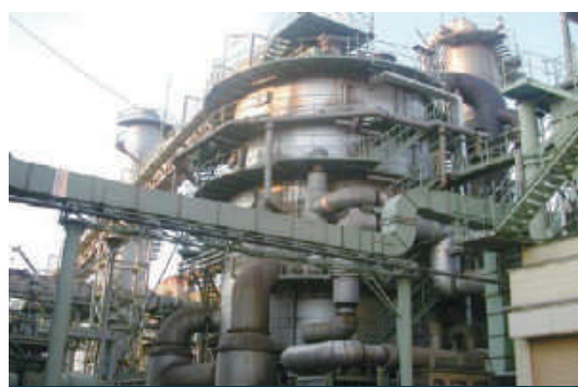
多段式汚泥焼却炉
