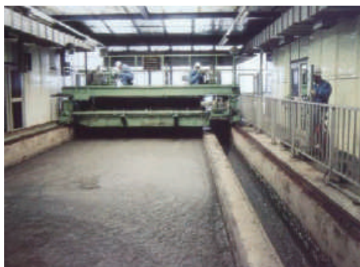
加圧浮上濃縮槽
