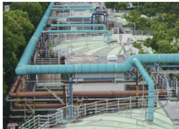
重力濃縮槽（砂町水再生センター）
