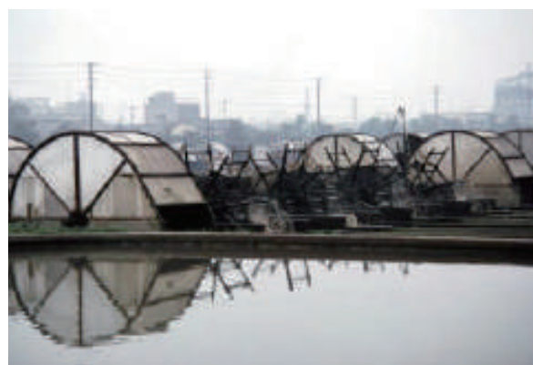
パドル式活性汚泥法 （1934年から1971年まで運転）
