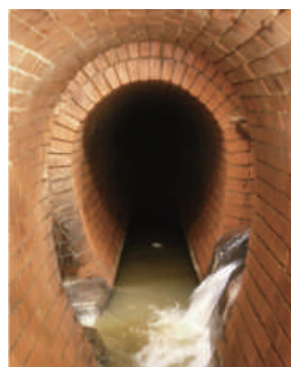
現在も使用されている 神田下水
