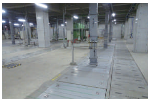
反応槽 （東処理施設・2021年）
