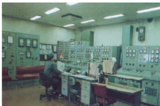
小台処理場中央監視室 （1964年）
