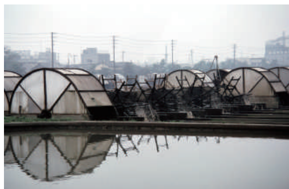
三河島污水処分場 パドル式活性汚泥法
