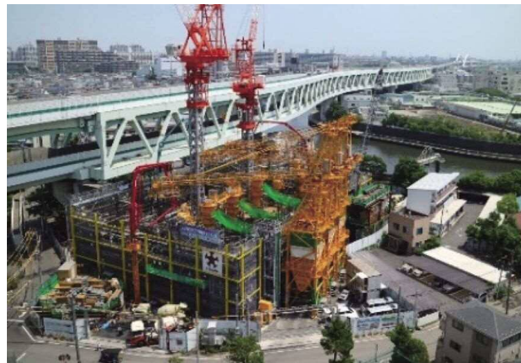
雨水ポンプ所の整備例 (王子第二ポンプ所)
