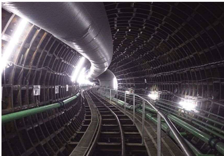
浸水対策幹線の整備例 (千川増強幹線)
