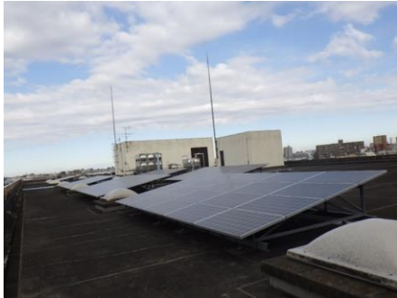
施設上部への設置例
