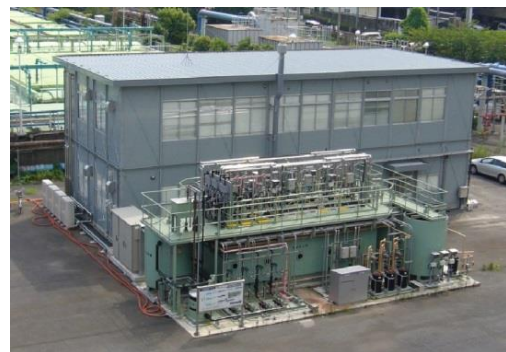
水処理実験プラントと実験棟
