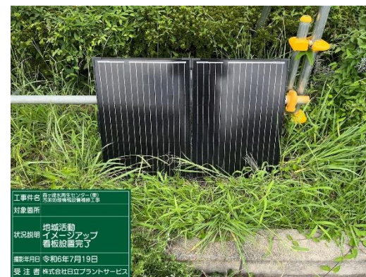
電源用ソーラーパネル
