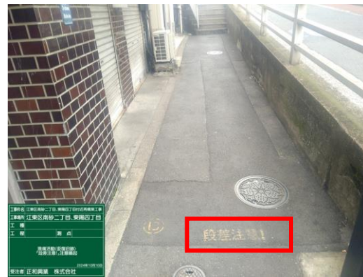
段差注意！表示
