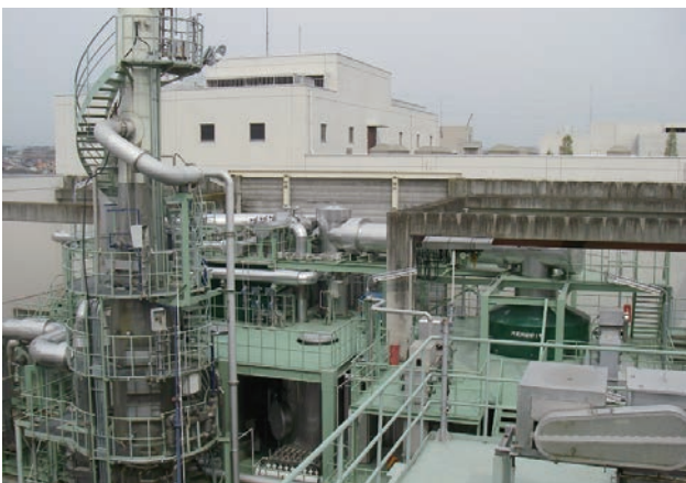
ターボ型流動焼却炉（浅川水再生センター）
