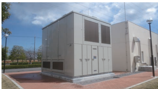
電力貯蔵設備 (NaS電池)
