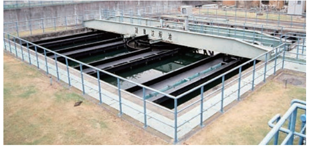
南多摩処理場 凝集沈殿池
