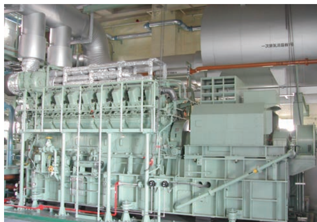
非常用発電設備
