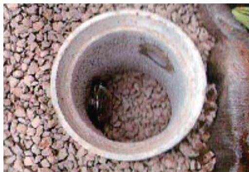
雨水浸透ます
