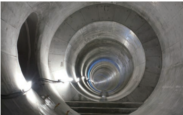
多摩川上流雨水幹線
