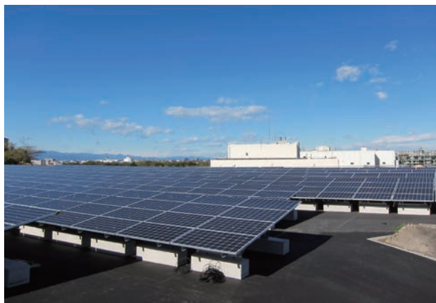
南多摩水再生センター太陽光発電設備
