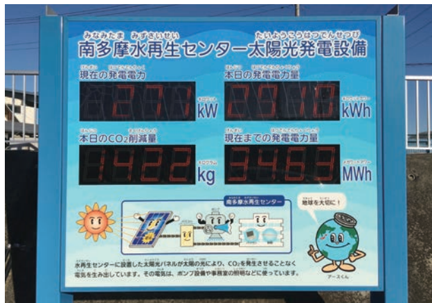
発電量モニター
