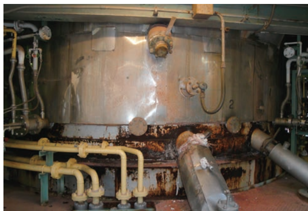
老朽化した焼却炉
