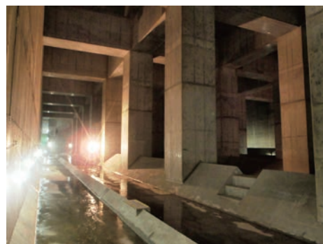
野川下流部雨水貯留池
