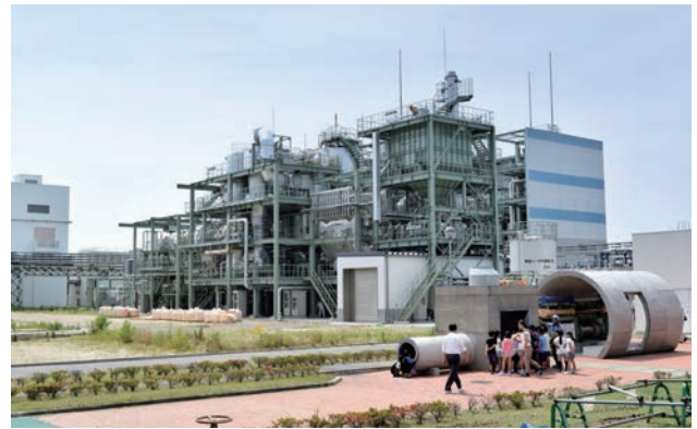
汚泥ガス化炉・バイナリー発電併設焼却炉 (南多摩水再生センター)
