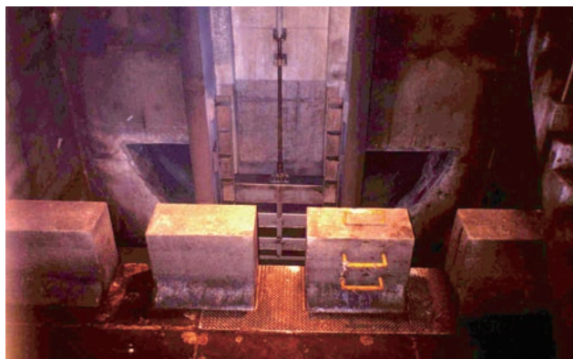
野川第二幹線（流量調整部）
