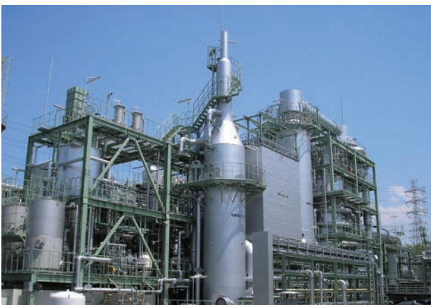
汚泥ガス化炉（清瀬水再生センター）
