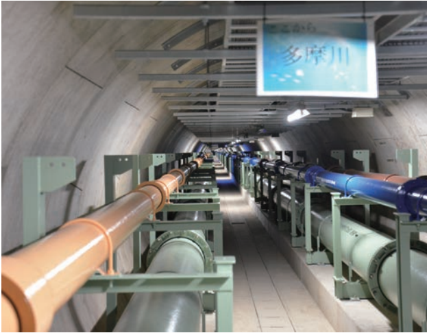
北多摩一号・南多摩水再生センター間連絡管
