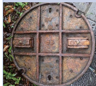
腐食したマンホール蓋
