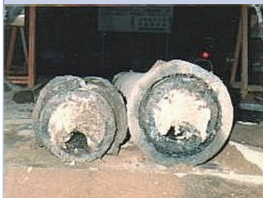
屋外排水管内の付着状況
