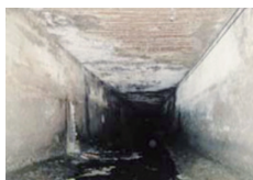
下水道管の老朽化
