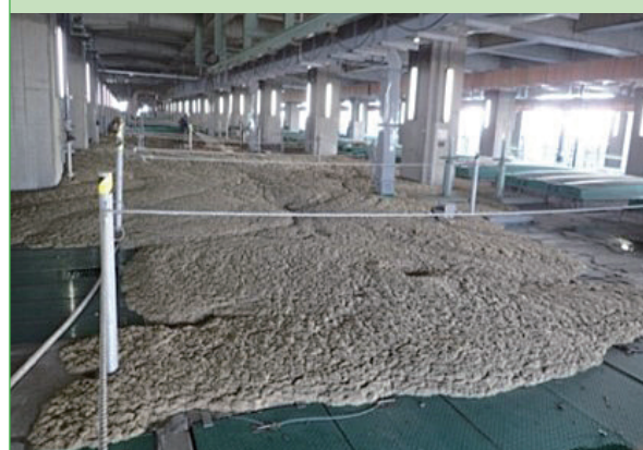
反応槽から流出した放線菌の泡
