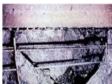
マンホール管口付近の破損
