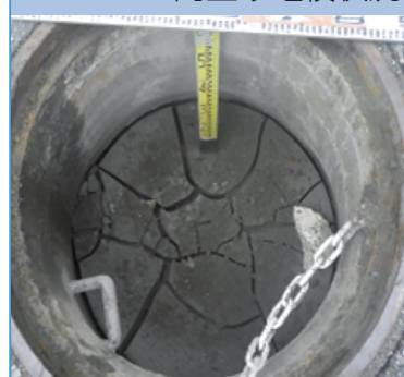
マンホール内土砂堆積状況
