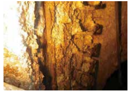
図3 角落し設置溝の腐食状況
