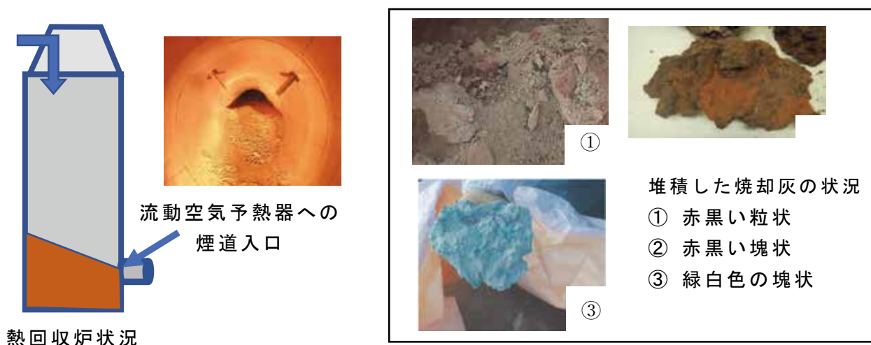
図 7 熱回収炉堆積状況
