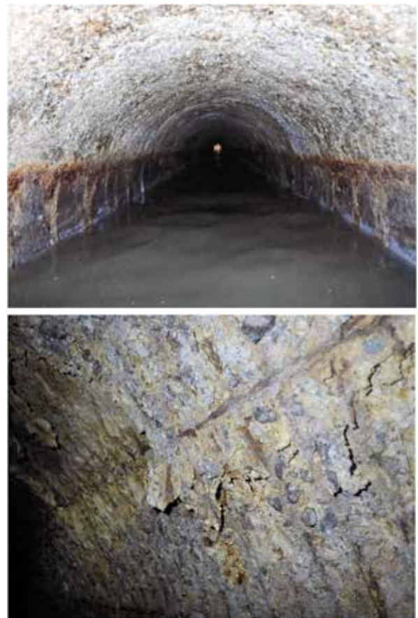
図 2 管きょの劣化状況
