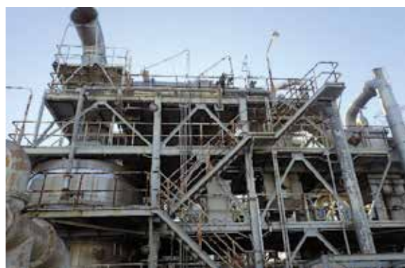
図4 北野下水処理場の老朽化した施設
