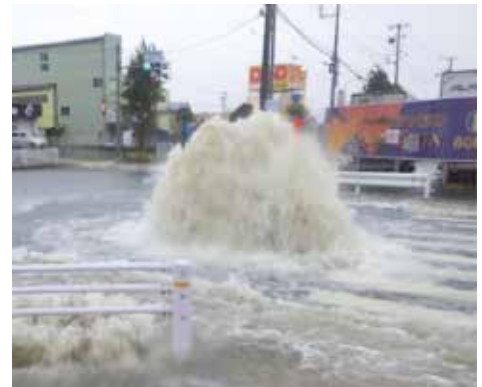
写真 1 流域下水道幹線からの溢水状況
