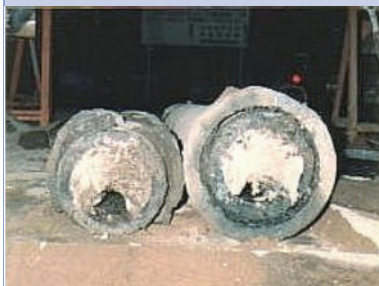
屋外排水管内の付着状況
