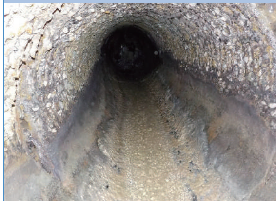
下水道管内部の腐食状況 (コンクリートが腐食し砂利がむき出し)
