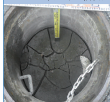
マンホール内土砂堆積状況
