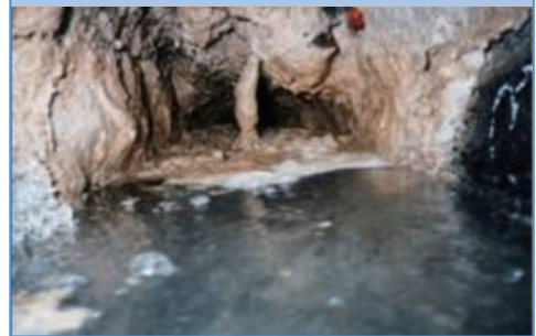
下水道管内に付着した油脂
