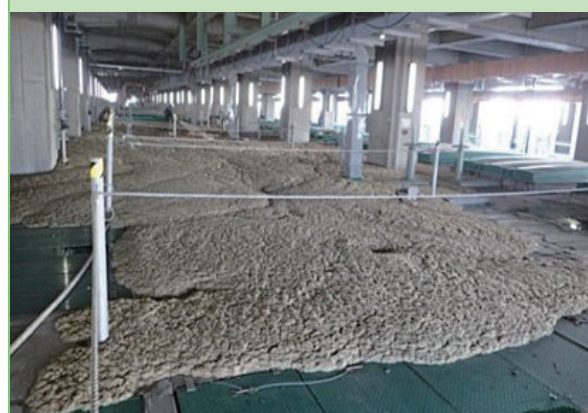
反応槽から流出した放線菌の泡
