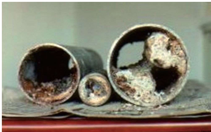
<被油脂堵住的室内排水管>
