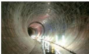
▲和田弥生幹線。中野区から 杉並区まで通っている直径 8.5m全長2.2kmの下水道管
