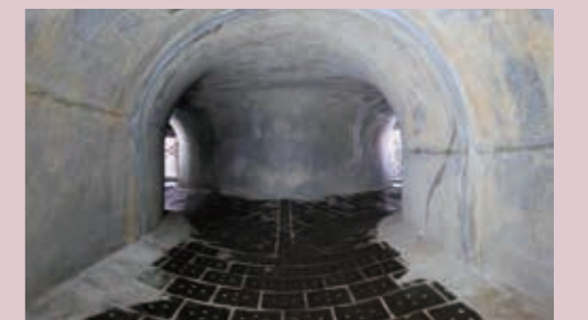
▲ 泵井连接暗渠
