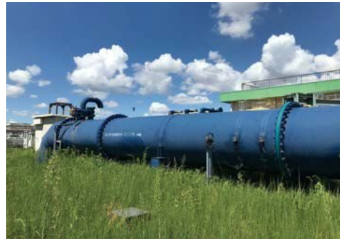
森ヶ崎水再生センター 小水力発電取水筒
