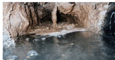
油が固まった下水道管
