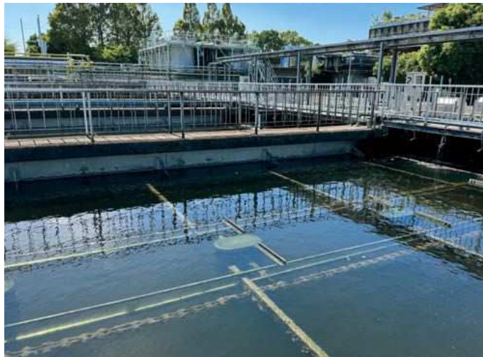
新河岸水再生センター 第二沈殿池
