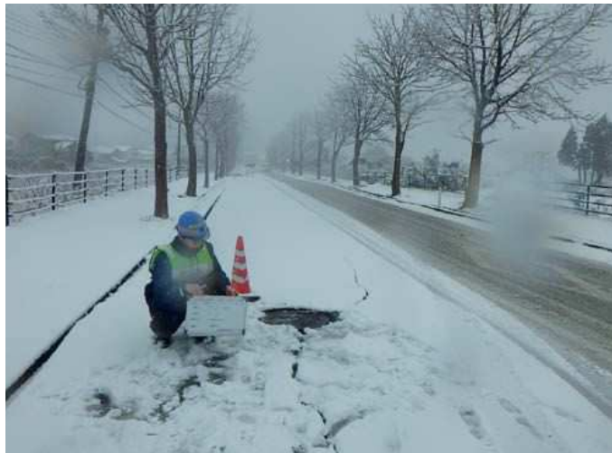
被災した下水道管の調査(令和6年能登半島地震への対応)
