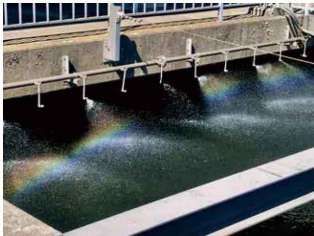
森ヶ崎水再生センター 第二沈殿池
