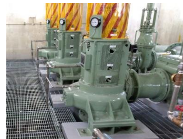
▲再構築を行ったポンプ設備 （新砂ポンプ所）
