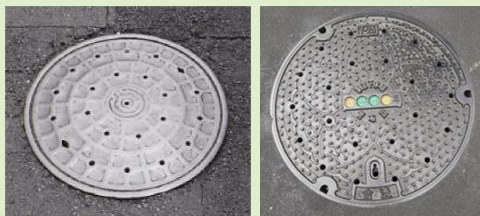
▲摩耗したマンホール蓋（左）と取替え後の耐スリップマンホール蓋（右）
