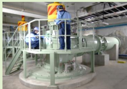
▲雨水ポンプの点検
