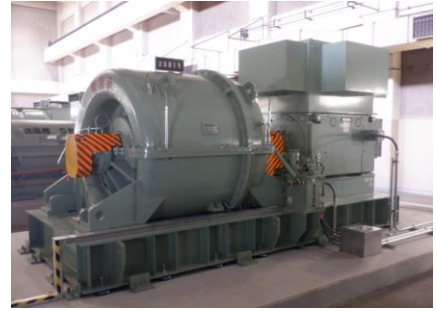
▲送風機 (清瀬水再生センター)
