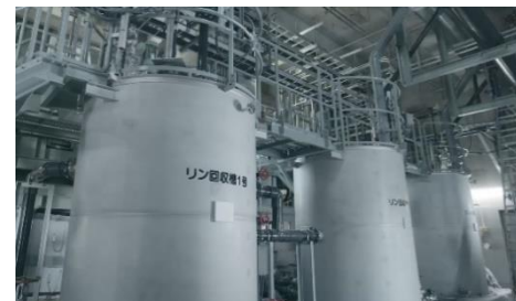
▲りん回収・肥料化施設
