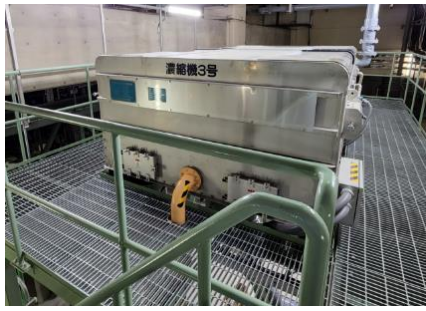
▲省エネルギー型のベルト型汚泥濃縮機 (南多摩水再生センター)
