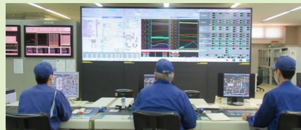
▲污泥処理施設の監視室
