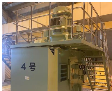
▲汚水ポンプ (八王子水再生センター)
