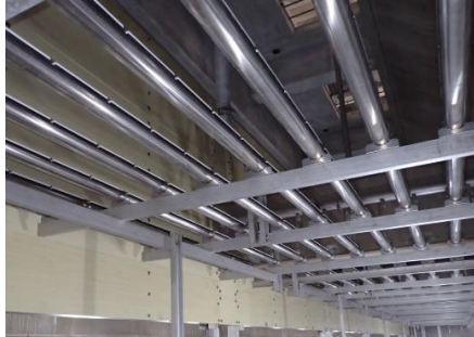
▲高密度配置型散気装置 (北多摩二号水再生センター)
