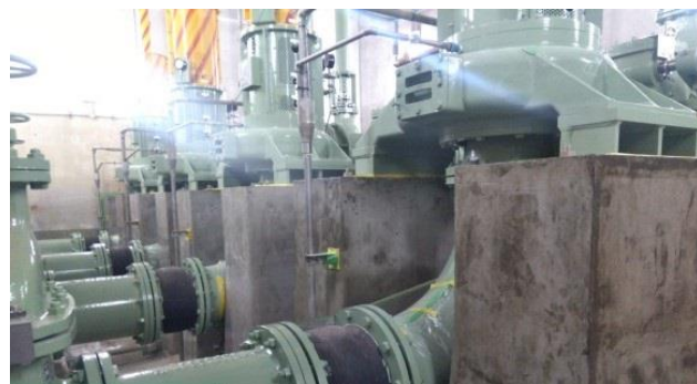
▲再構築した新砂ポンプ所のポンプ設備
