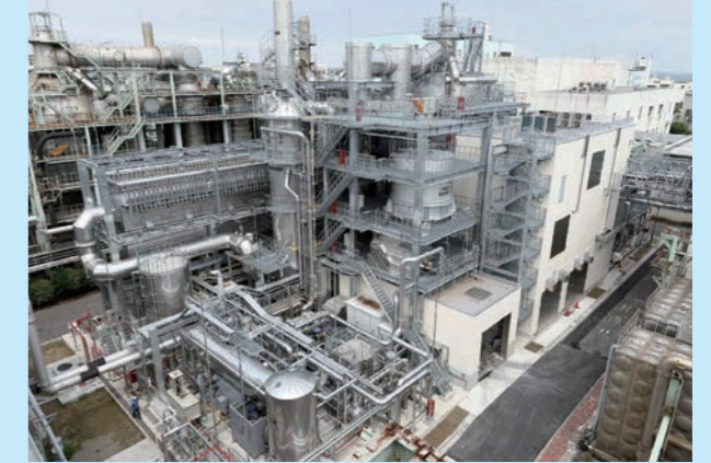
▲多層燃焼炉(7号炉)
