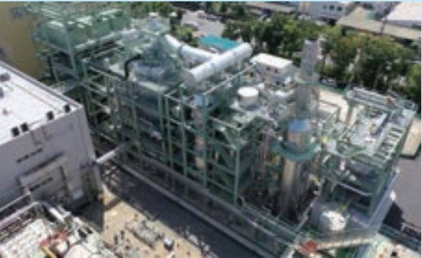
▲多層燃焼炉（新3号炉）
