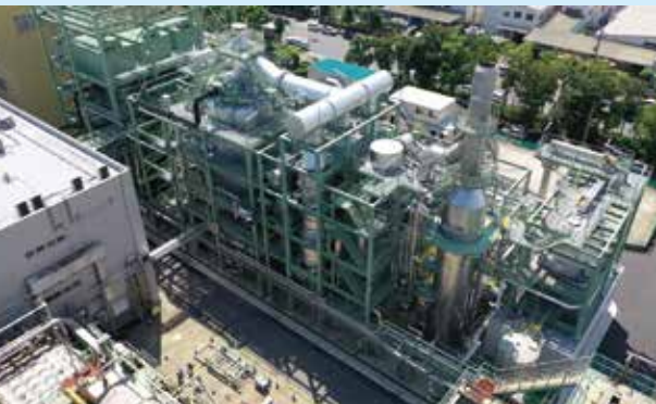
▲多層燃焼炉（新3号炉）
