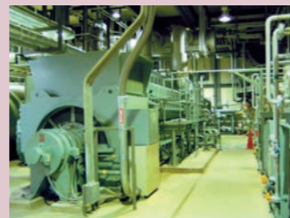
▲ガスエンジン発電機
