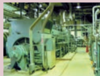
▲ガスエンジン発電機
