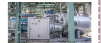
▲発電機(最大出力980kW)
