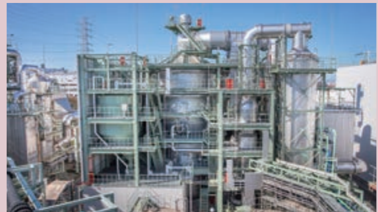
▲汚泥焼却炉(エネルギー自立型焼却炉)
