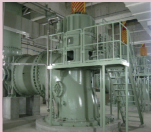
▲神谷ポンプ所雨水ポンプ設備
