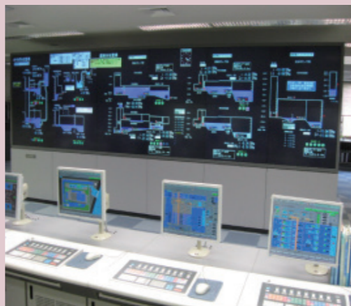
▲みやぎ水再生センター中央監視室
